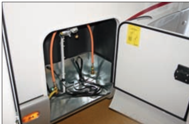
Oppbevaringsrommet for gassflaskene.
