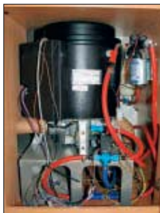
Trumavarmeren sitter som vanlig trangt i det, og ledningsføringen er rotete.
